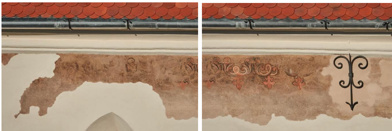
Detaliu – Fragment de pictură murală de pe fațada de Sud
